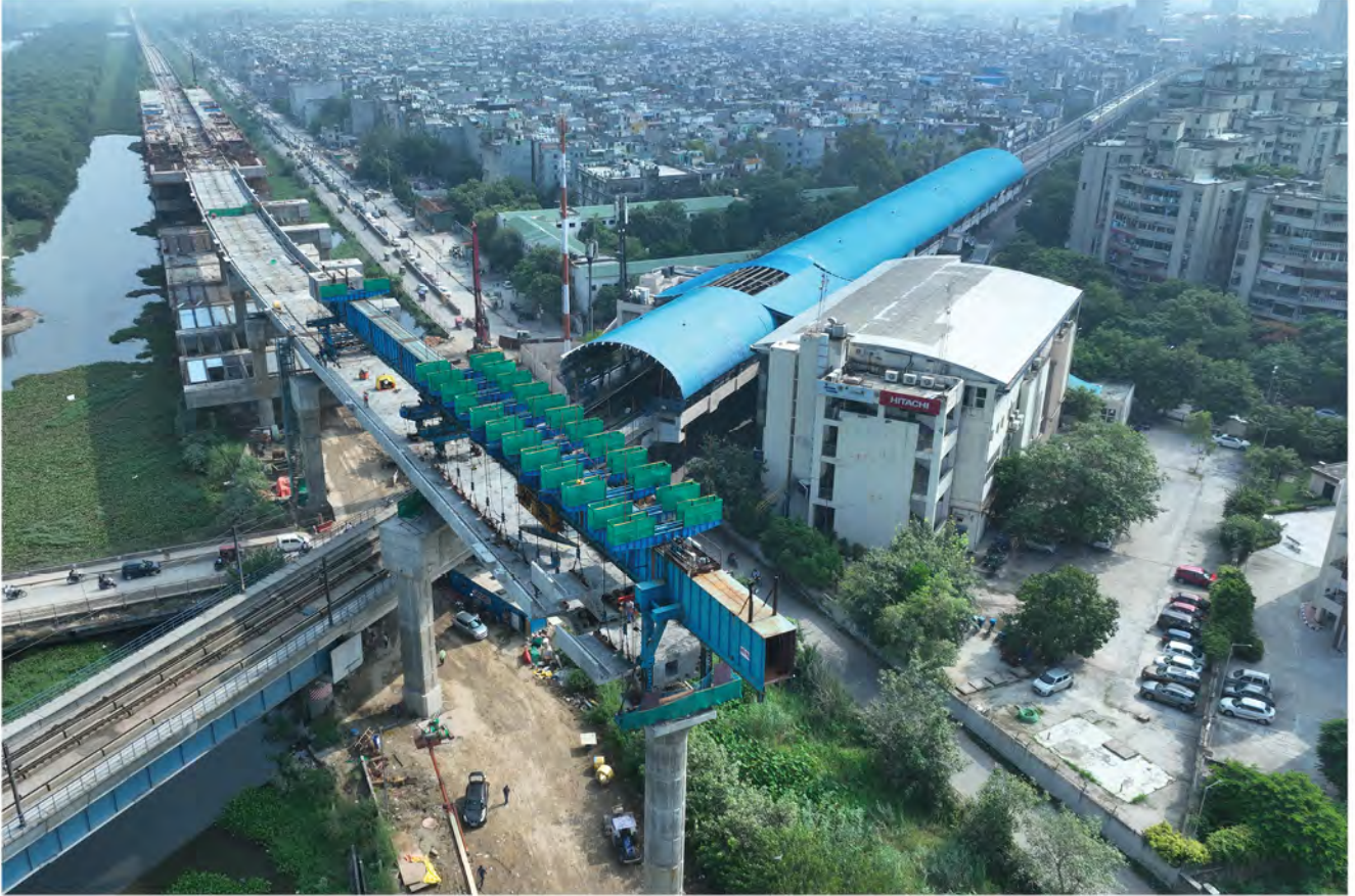
न्यू अशोक नगर में आरआरटीएस वायाडक्ट ने 20 मीटर की ऊंचाई पर दिल्ली मेट्रो ब्लू लाइन को किया क्रॉस
